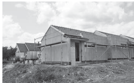
V červenci byl penzion pro seniory oděn do slušivého kabátku, nové fasády.
